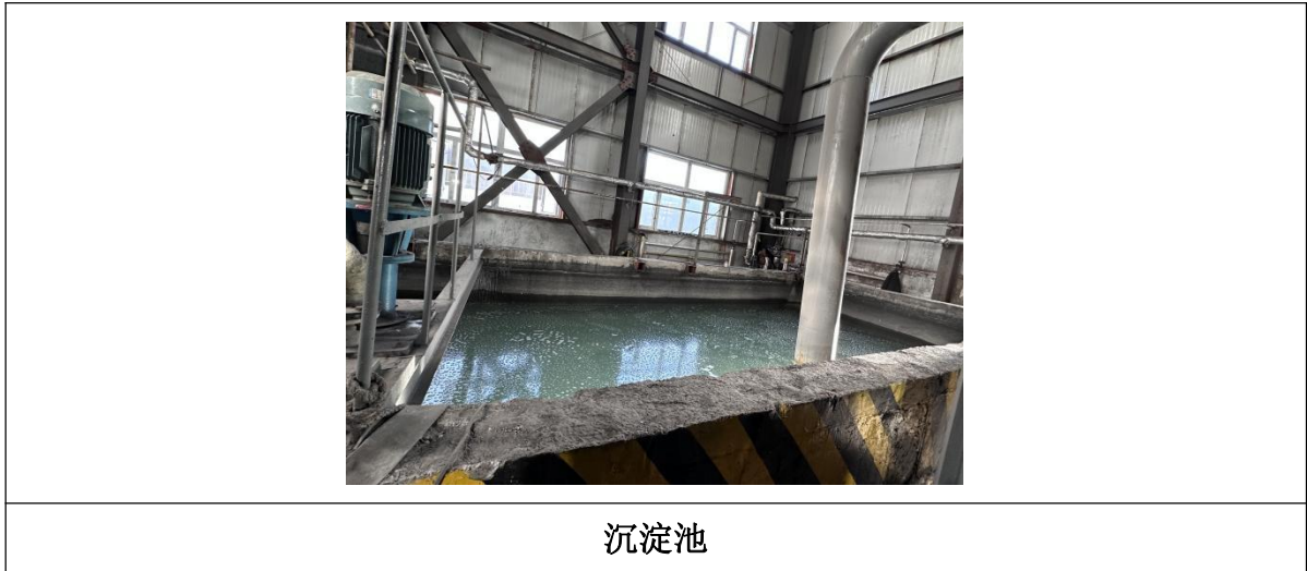
图 4-1 项目污染物处理措施现场照片
